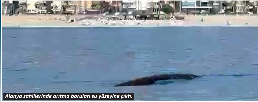
Alanya sahillerinde arıtma boruları su yüzeyine çıktı.
