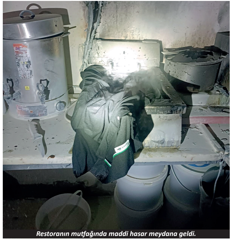
Restoranın mutfağında maddi hasar meydana geldi.
