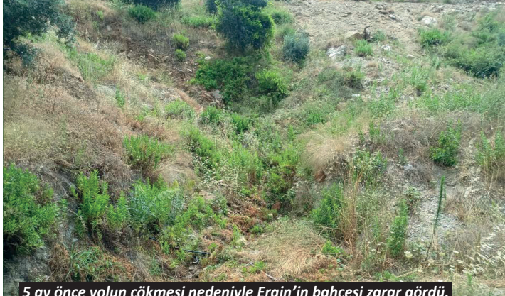
5 ay önce yolun çökmesi nedeniyle Ergin'in bahçesi zarar gördü.
