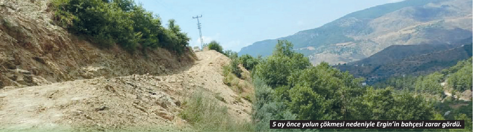
5 ay önce yolun çökmesi nedeniyle Ergin'in bahçesi zarar gördü.
