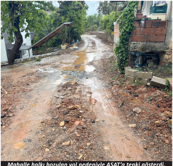
Mahalle halkı bozulan yol nedeniyle ASAT'a tepki gösterdi.
