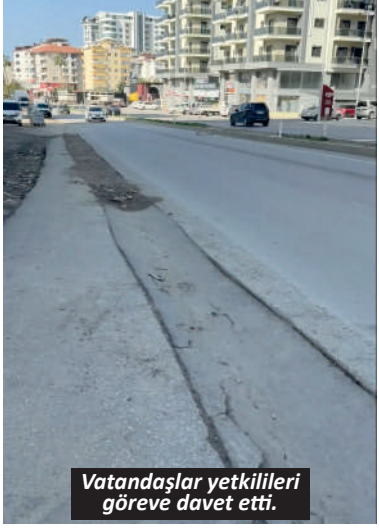
ASAT'ın dolgu malzemesi döküldüğü kısımda çökme meydana geldi.
