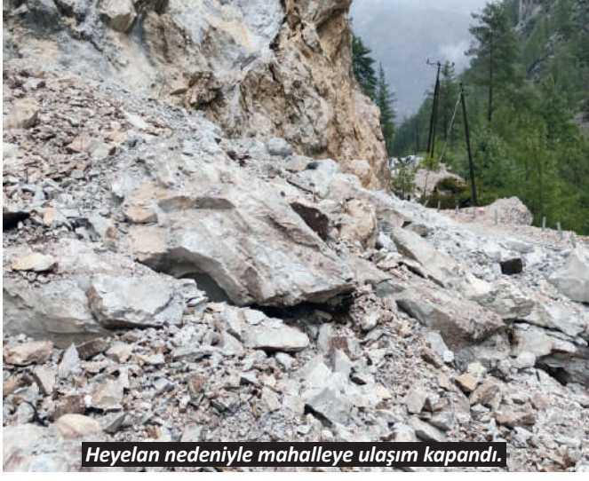
Heyelan nedeniyle mahalleye ulaşım kapandı.
