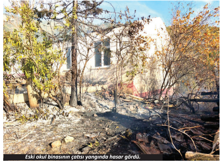
Eski okul binasının çatısı yangında hasar gördü.
